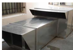
Caissons pour climatisation
